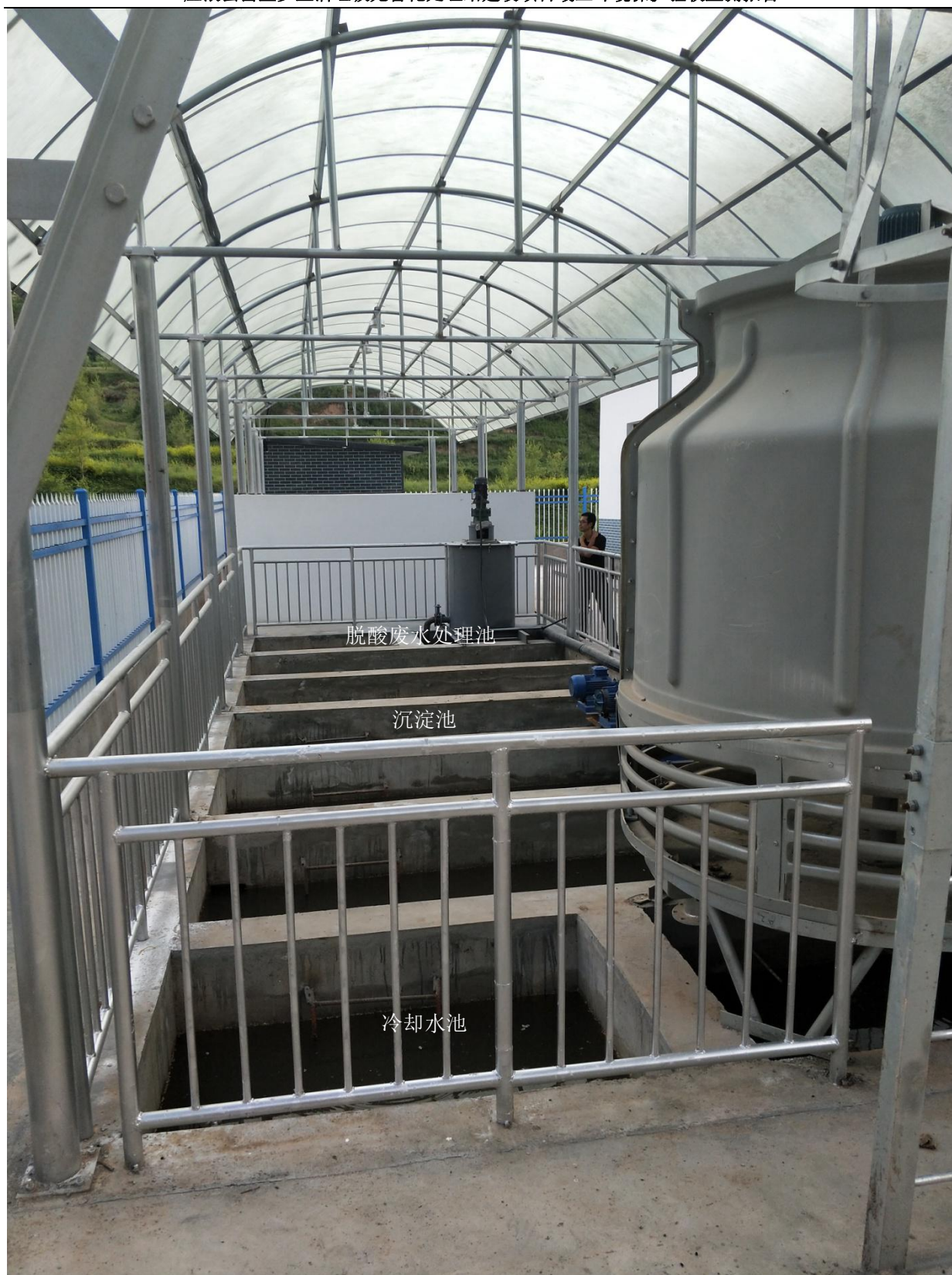
图 4-5 污水处理设施
